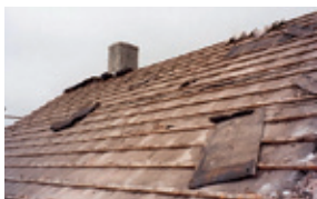
Dégradation de la structure du bâtiment
