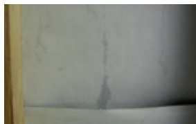
Dommages causés par des infiltrations d'eau
