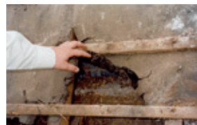
Inefficacité de l'isolation
