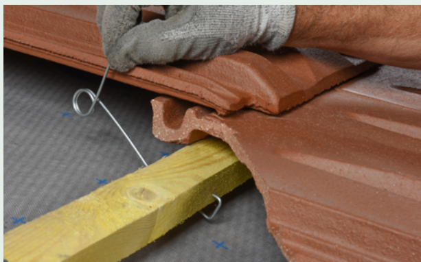
3- La mise en œuvre peut se faire aussi facilement à la main.
